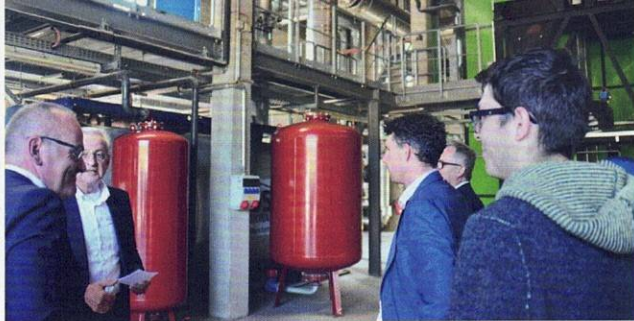
Das Biomasseheizwerk in der Schottenau im Hintergrund versorgt bereits seit 2010 das Krankenhaus Eichstätt und zahlreiche Liegenschaften der Universität und der Kirche sowie der Bayerischen Bereitschaftspolizei. Es verbessert die CO 2 -Bilanz der Stadt bei einer Wärmeabgabe von rund 15 Millionen Kilowattstunden um jährlich rund 2.200 Tonnen.
